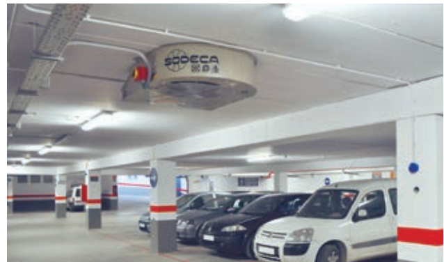
CI instalado en parking
