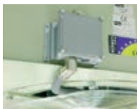
Caja de conexiones en el exterior
