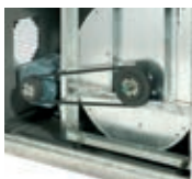
Motor fuera del paso del aire
