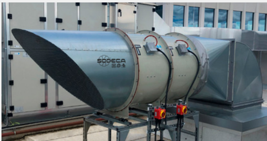
DEPRESURIZACIÓN DE ESCALERAS Penrose Dock, Irlanda
