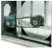
Motor fuera del paso del aire
